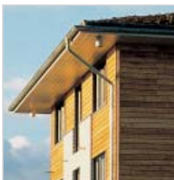
Der große Dachüberstand fängt im Winter Sonne ein und spendet der hohen Fassade im Sommer Schatten.
